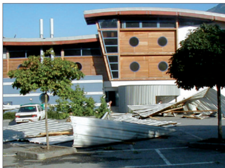
Une toiture emportée par le vent
