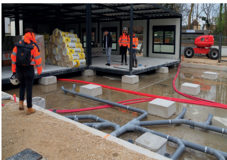
Vue sur la dalle et plots béton sur lesquels sont posés les modules, ainsi que sur les différents réseaux
